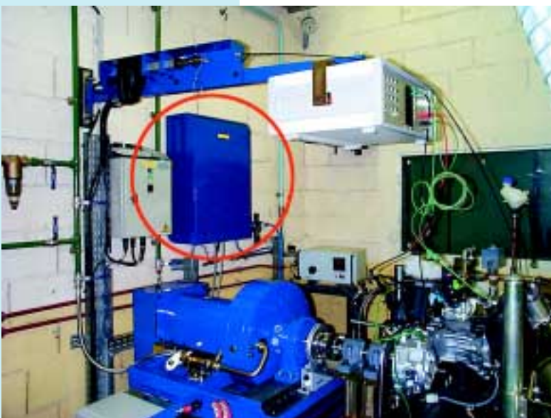
DMC 202 avec son capot de protection installé dans une cellule d'essai
